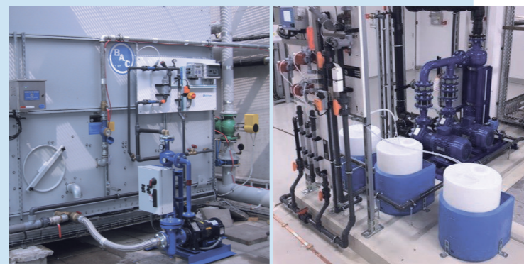
Tratamiento de agua
