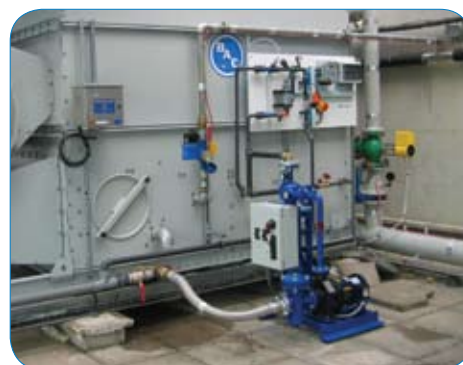
Installation de filtration
